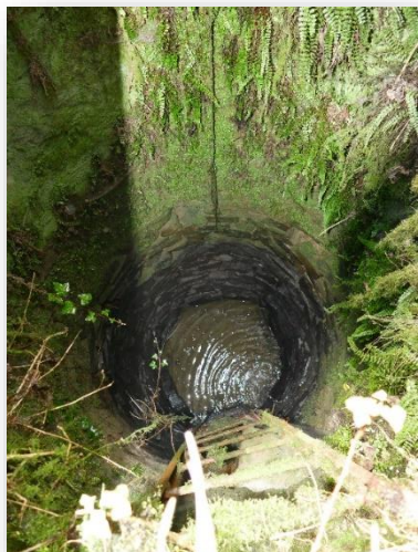
Puits-regards de contrôle des niveaux Cliché de l'auteur
