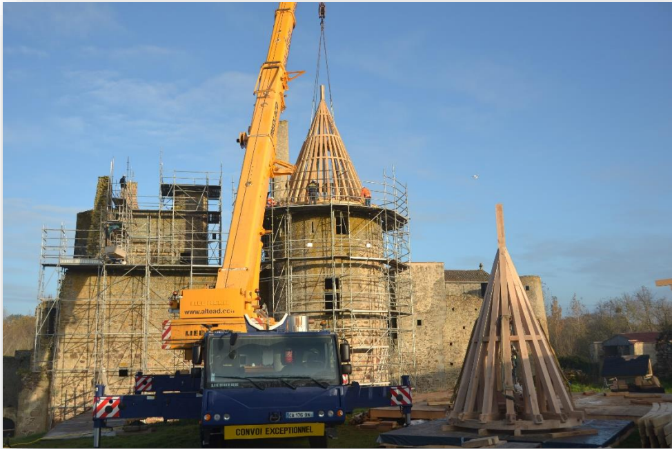
Le château de Glenay (ici en cours de restauration) était la résidence de la famille Richard au XVIII e siècle. Crédit Carl Guillet 2021
